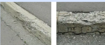
凍結融解による流込み製品の被害状況
