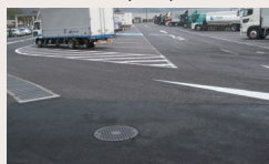
マンホール蓋 (T-25)
