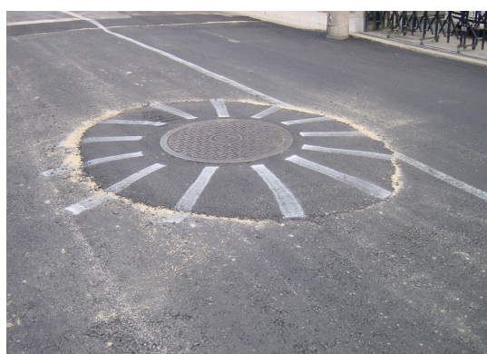
切削後の マンホールの段差…
