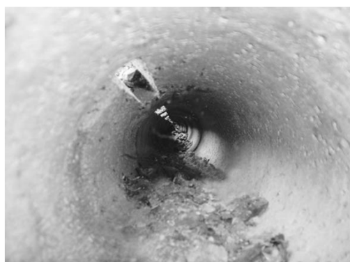
養生無しでの施工で、管路内に碎石、AS合材が堆積している状況。
